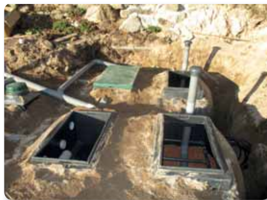
Cuves du substrat filtrant
