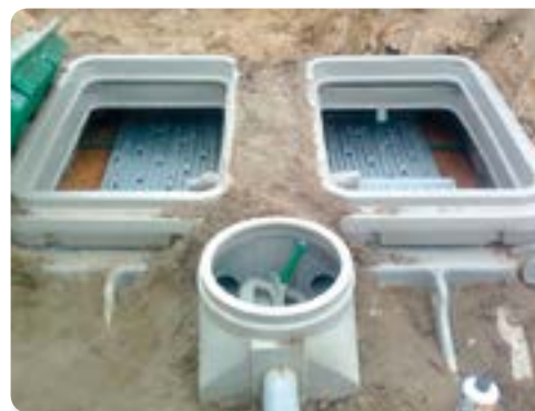
Un exemple de système de traitement : le filtre compact
